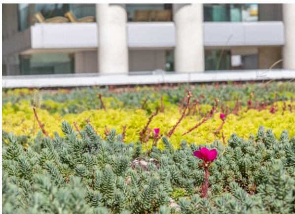
Techo verde extensivo en primavera.
